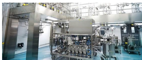
今年初，合全药业位于常州的寡核苷酸原料药公斤级生产车间已经正式投入运营
